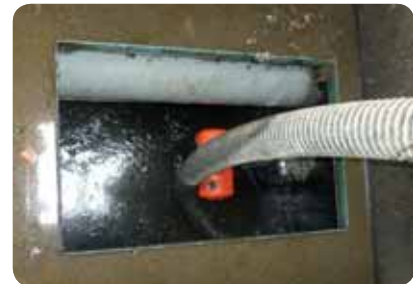
Vue de la chambre séparateur
