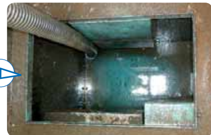
Vidange de la chambre séparateur
